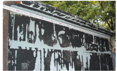
12年経過後の試験体状況 (チタン箔シート剥離後)
